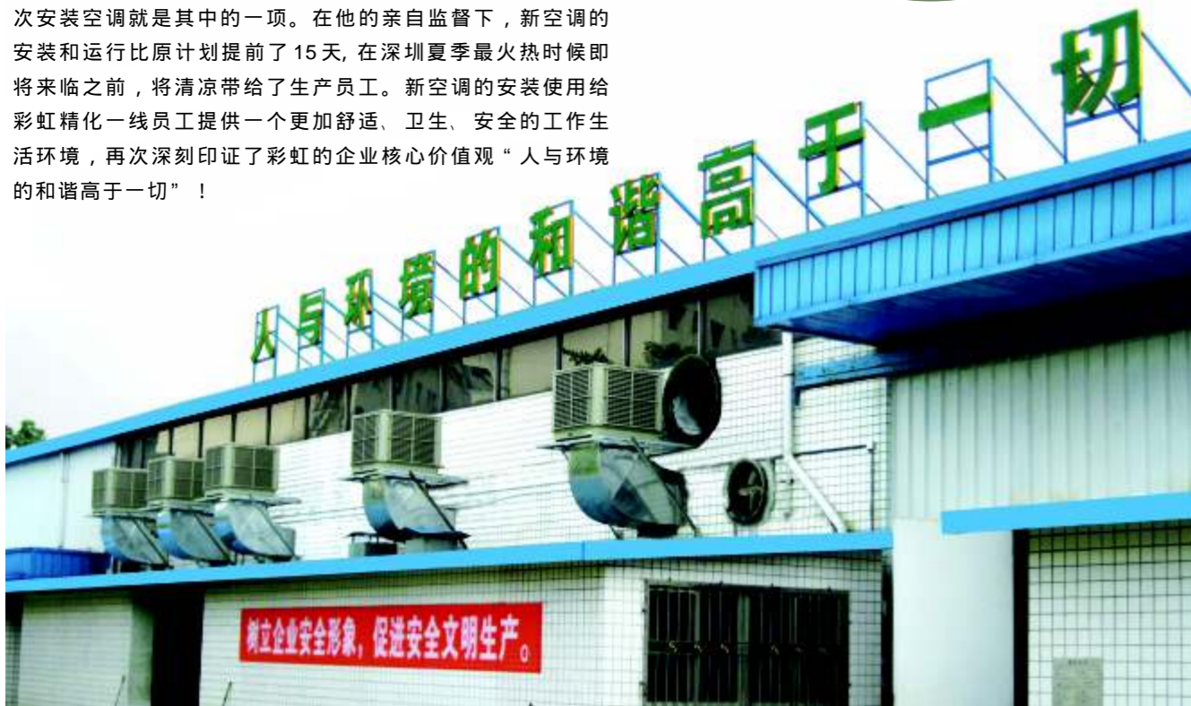
安装了新空调的车间
